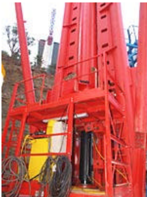
Nahaufnahme einer der vier Seiten der Kubusstruktur mit den "Zahnstangen" und dem integrierten Hydrauliksystem von Enerpac mit Zylinder, Pumpe und PLC-Steuerungseinheit zum Anheben der temporären Zwischenstützen.
